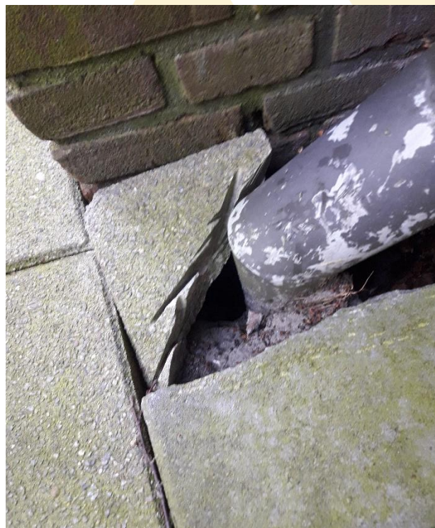
Foto 14: Verzakt straatwerk in de wijk
