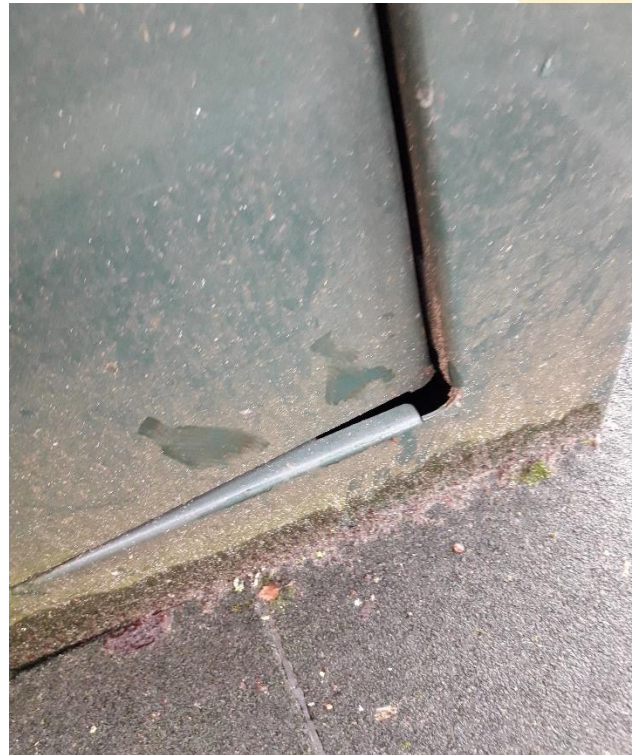
Foto 22: Openingen in gebouwen in de wijk; worden wellicht gebruikt door ratten
