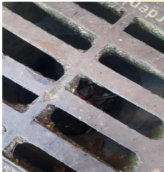
Foto 2: Vervuilde straatkolk schoolplein
