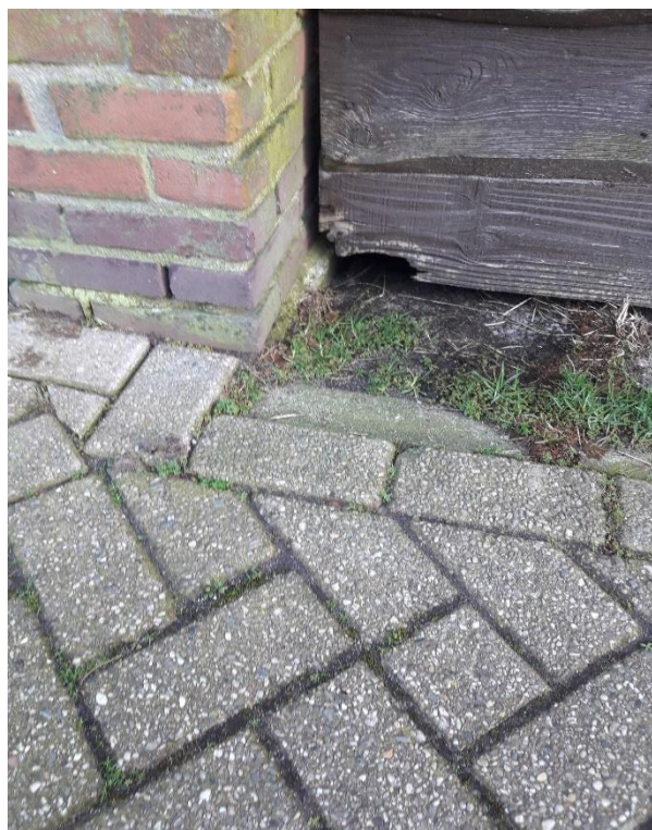
Foto 20: Openingen in gebouwen in de wijk; worden wellicht gebruikt door ratten
