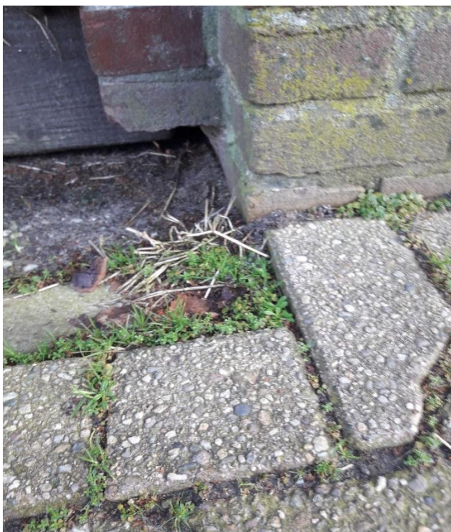
Foto 19: Openingen in gebouwen in de wijk; worden wellicht gebruikt door ratten
