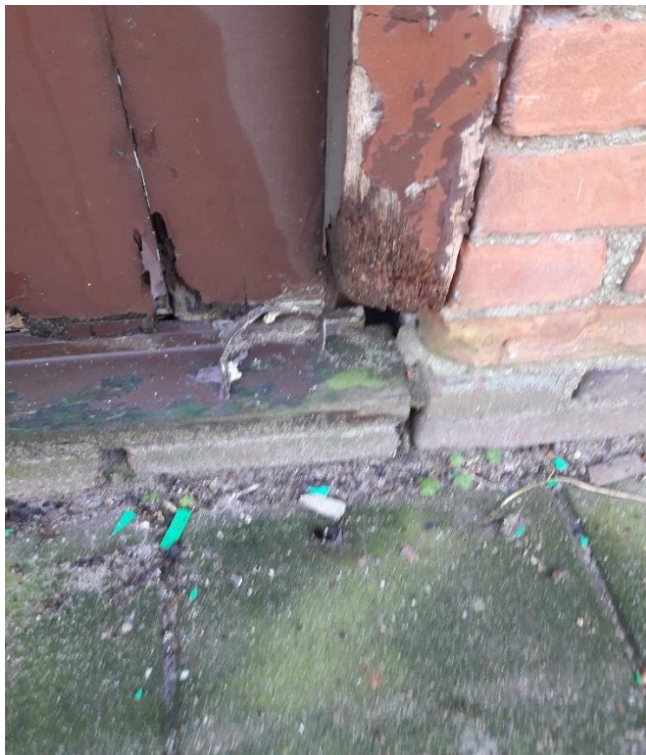
Foto 21: Openingen in gebouwen in de wijk; worden wellicht gebruikt door ratten
