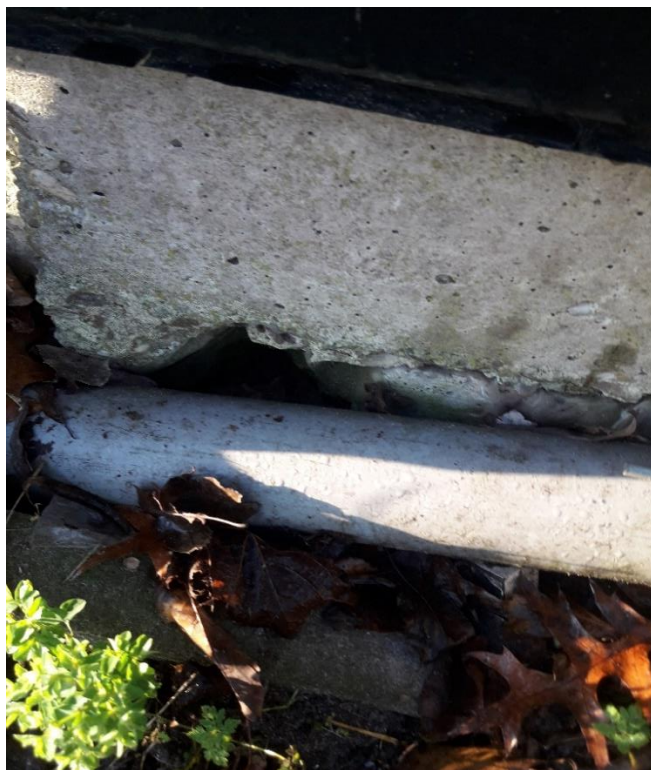
Foto 17: Verzakt straatwerk in de wijk
