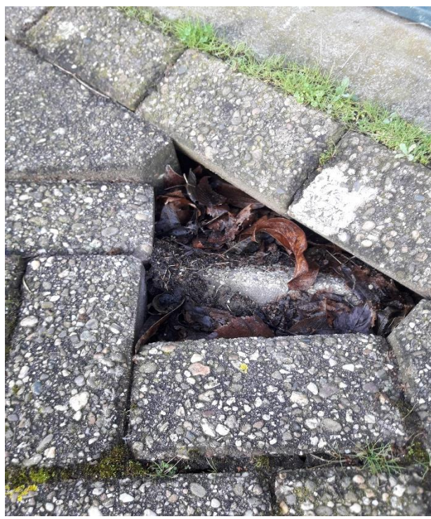
Foto 16: Verzakt straatwerk in de wijk
