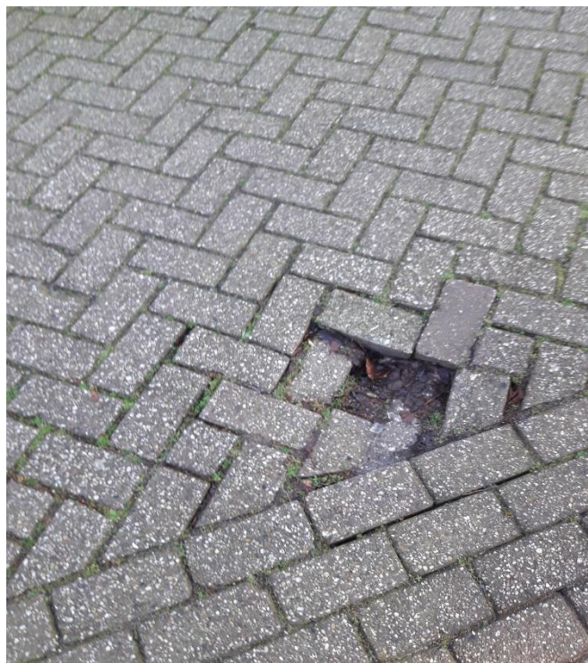
Foto 15: Verzakt straatwerk in de wijk
