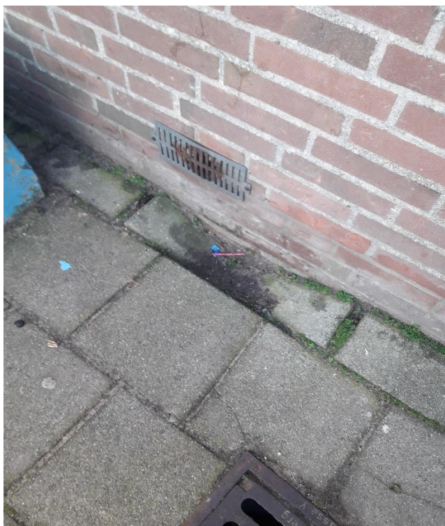
Foto 11: School, verzakkingen straatwerk
