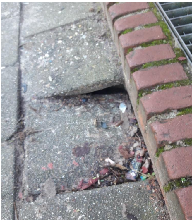
Foto 13: Verzakt straatwerk in de wijk
