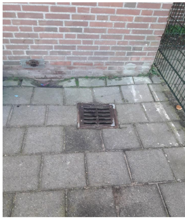
Foto 12: School, voedselresten en verzakking straatwerk
